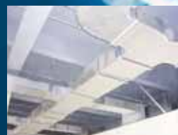
Air ducts Canalizzazioni
